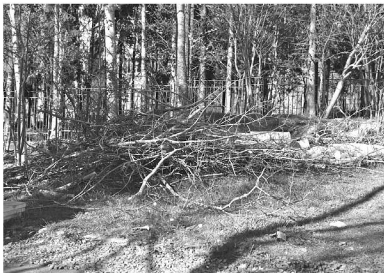
Мусор, оставленный строителями
