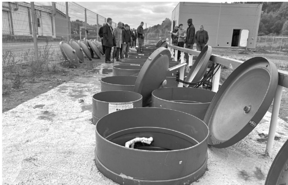
Система очистных сооружений АО «Кала-Ранта». Баки биологической очистки отходов
