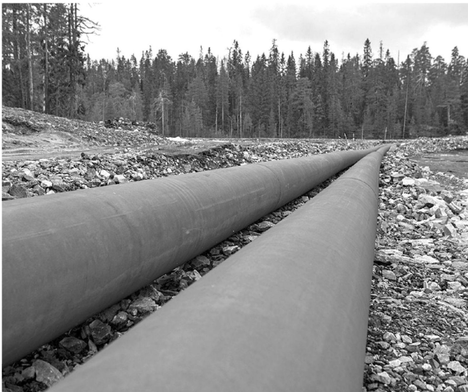
По этим трубам вода из карьеров поступает в водосборник
