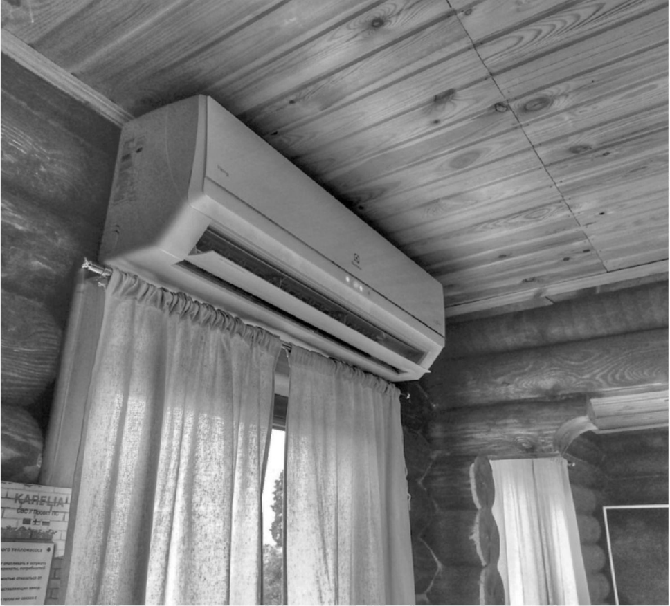
Тепловой насос, вид изнутри
